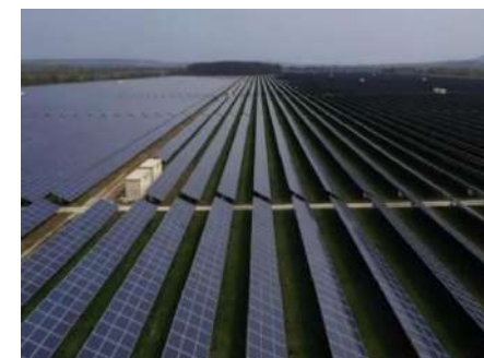
Photographie du parc photovoltaïque "Karad" - Bulgarie
